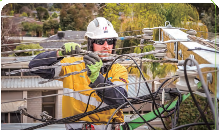
United Energy 定期進行預防性維護以確保可靠性。
