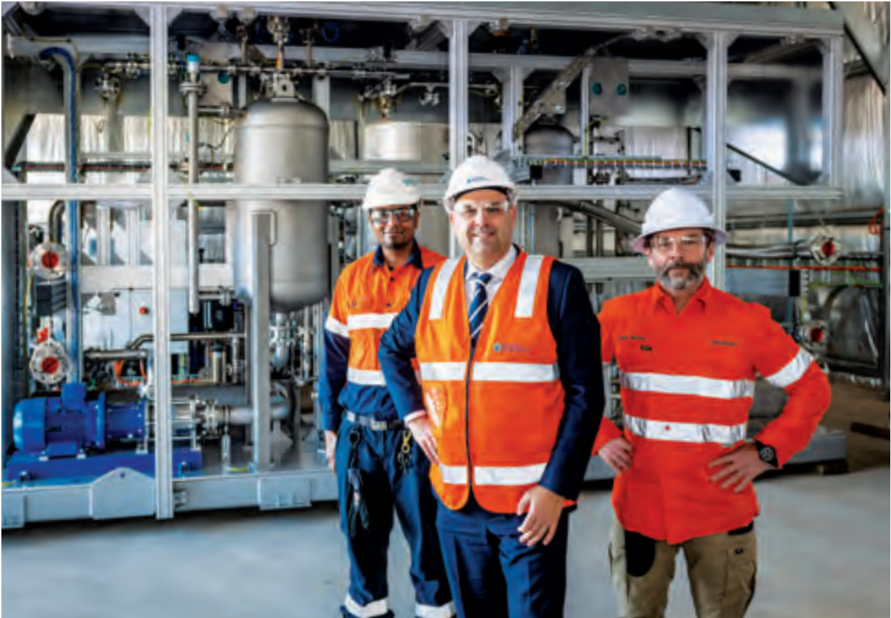
Australian Gas Networks 位於阿德萊德的 Hydrogen Park South Australia 氫氣製造設施之籌備工作現已進入最後階段，該項目利用一點二五兆瓦的電解裝置製造可再生氫氣。
